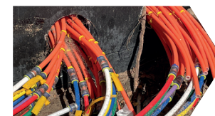
Glasfasereinführung in einen Hauptverteiler
